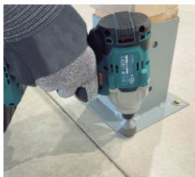
Aplicações em instalações industriais.
